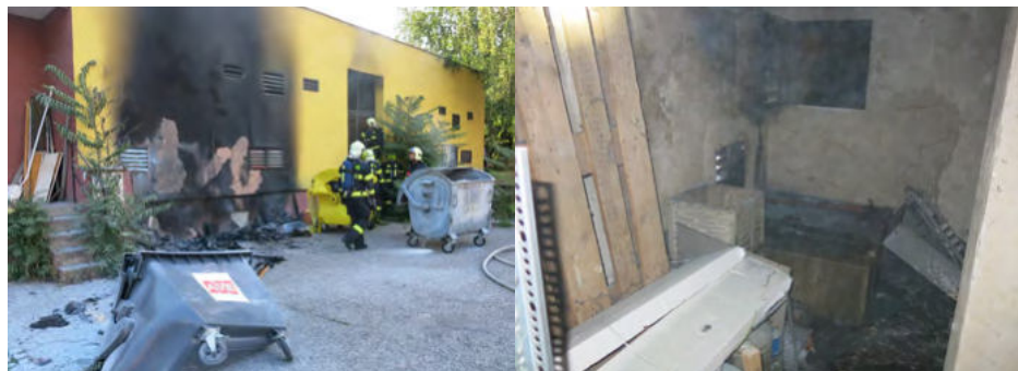
Rozšíření požáru kontejneru do objektu.
